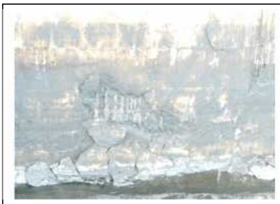
Gambar. 1 Kondisi kerusakan internal struktur beton Storm water basin di Unit EWTP
