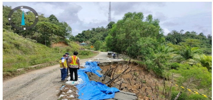
Gambar 3.2 Dokumentasi Kondisi longsor
