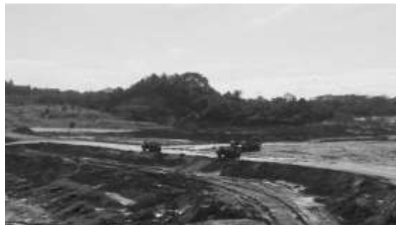
Gambar 4. Kondisi Aktual Jalan Tanjakan
