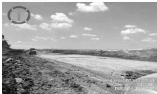
Gambar 1. Kondisi Aktual Jalan Akses Segmen Jalan Lurus
