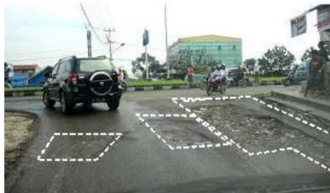
Gambar 1. Jalan Kondisi Rusak [4]
