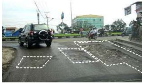
Gambar 1. Jalan Kondisi Rusak [4]
